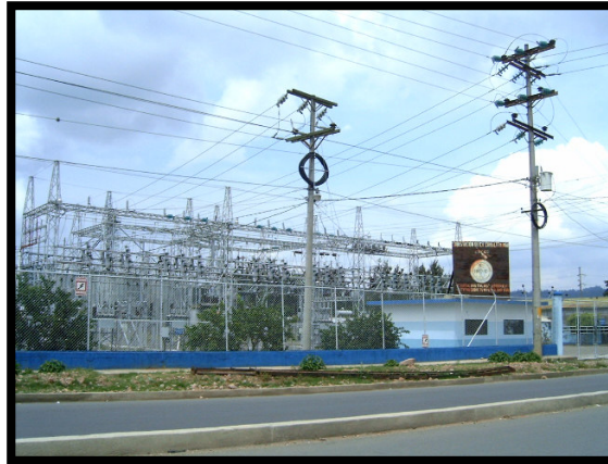
Figura 14. Fotografías de subestación y alumbrado público, a) subestación localizada en el camino viejo que conduce a el Tejar, Chimaltenango, b) alumbrado público dentro del sector estudiado.
