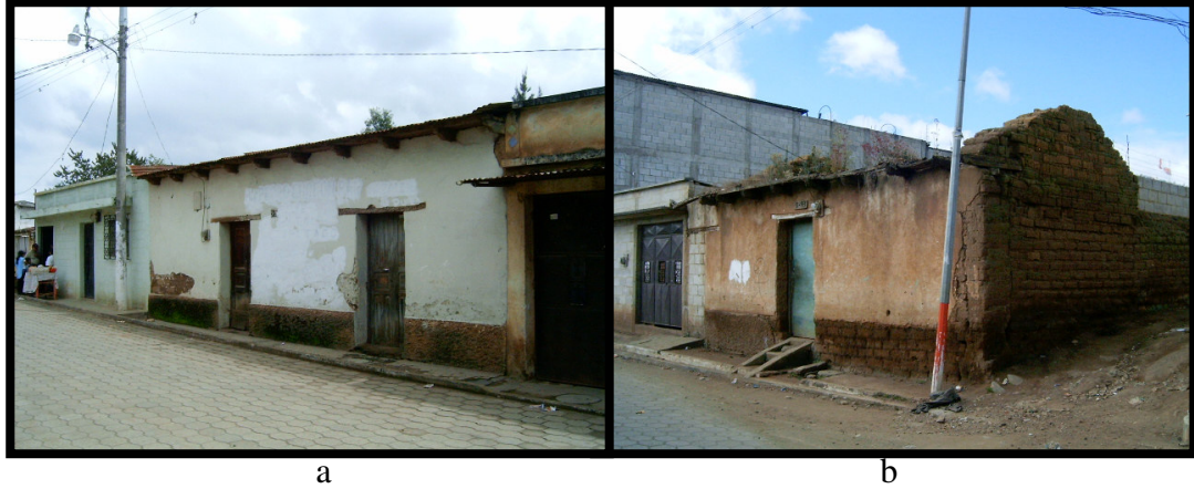
Figura 19. Ejemplos de problemas típicos observados en estructuras de mampostería no reforzada.
