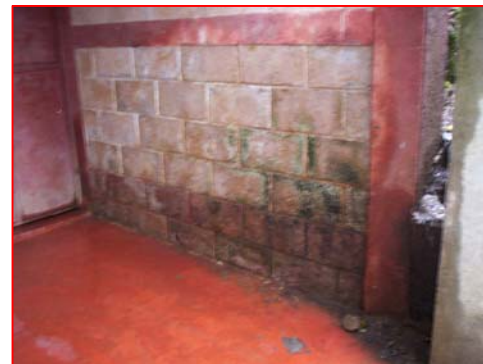
FOTOGRAFIA 3 Muro deteriorado, con humedad y hongo.
