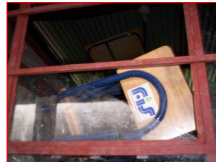
FOTOGRAFIA 3 Vidrios rotos y mobiliario subutilizado.
