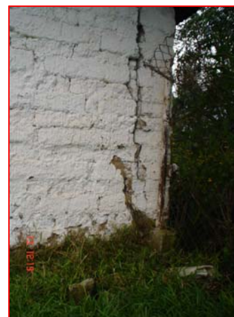
FOTOGRAFIA 1 Grieta estructural en muro de adobe.
