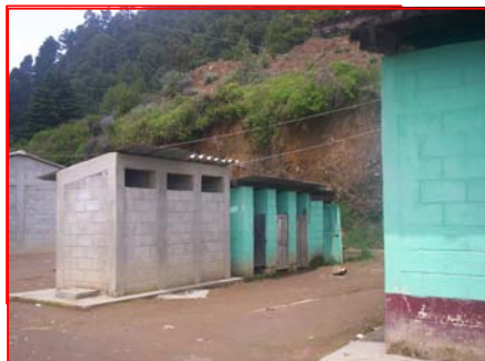
FOTOGRAFIA 1 Letrinas en mal estado
