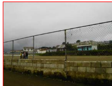
FOTOGRAFÍA 3 Campo de Fútbol, contiguo a Escuela, se observa humedad en la base del muro perimetral, así como deterioro en la malla circundante.
