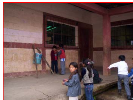
FOTOGRAFIA 1 Estudiantes durante su tiempo de recreo, se observa grieta en la losa del piso.
