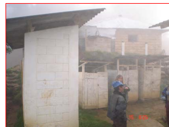
FOTOGRAFIA 2 Letrinas en mal estado.
