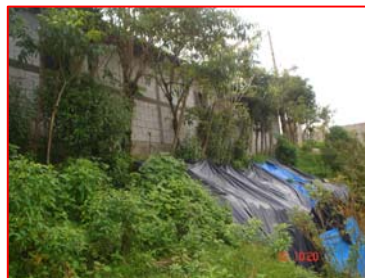
FOTOGRAFÍA 2 Talud sin tratamiento, alredeño a la escuela.
