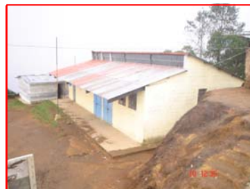
FOTOGRAFIA 2 Escuela aledaña a corte de terreno sin tratamiento.
