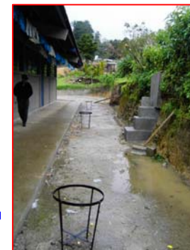
FOTOGRAFIA 6 Corte del Terreno, aledaño a Escuela, al cual se le debe de realizar trabajos de contención.
