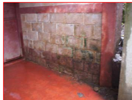
FOTOGRAFIA 4 Humedad en muros.
