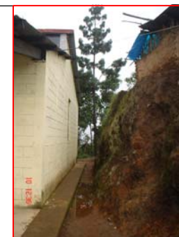
FOTOGRAFIA 6 Corte de terreno aledaño a muro de escuela.
