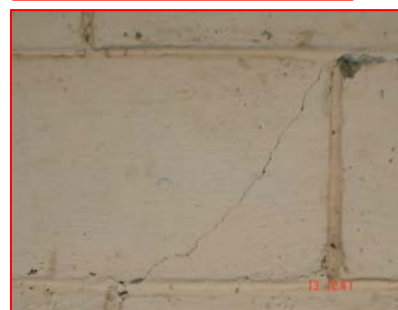
FOTOGRAFIA 2 Grieta estructural en muro de block.
