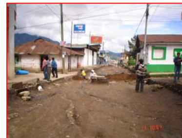
FOTOGRAFÍA NO. 4 En esta zona se realizan trabajos de adoquinamiento en calles del casco urbano de Tacaná, se puede observar estudiantes en su camino a la escuela y la falta de evidente de espacios para la circulación de peatones.
