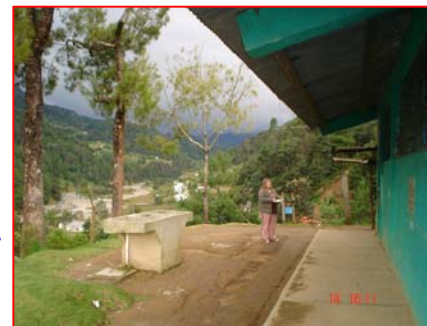
FOTOGRAFIA 2 Plta de la escuela, hace falta tratamiento en caminamientos.
