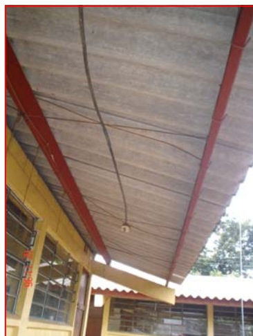
FOTOGRAFIA 1 Instalación eléctrica expuesta.
