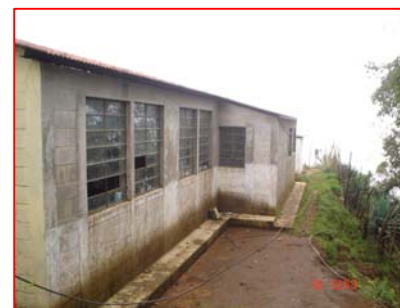
FOTOGRAFIA 3 Muro posterior, con muestras de humedad, vidrios rotos en las ventanas. Instalación de Agua vista.
