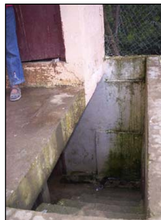
FOTOGRAFIA 1 Humedad y deterioro en módulo de letrinas.
