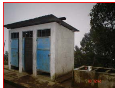
FOTOGRAFIA 2 Letrinas en mal estado.
