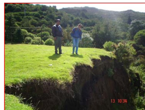
FOTOGRAFIA 2 Deslizamiento cercano a solar de la Escuela
