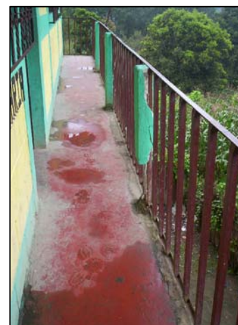
FOTOGRAFIA 2 Baranda de corredor en mal estado.
