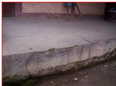
FOTOGRAFIA 1 Grietas en fundición de piso.
