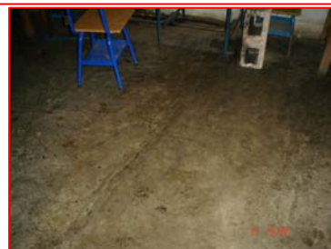
FOTOGRAFIA 2 Piso de cemento fundido, con grietas estructurales.
