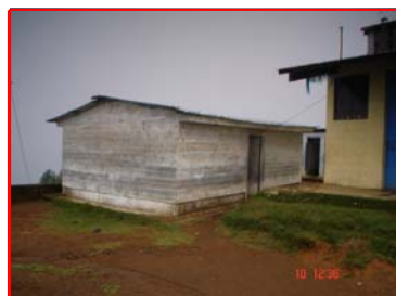
FOTOGRAFIA 4 Aula de madera, en mal estado.
