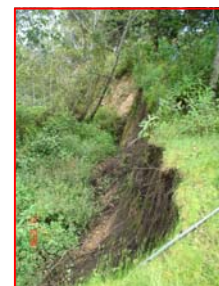
FOTOGRAFÍA 4 Talud sin tratamiento, en el solar donde se encuentra el Centro de Convergencia Comunitario.
