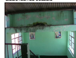
FOTOGRAFIA 06 HUMEDAD EN DUCTO DE GRADAS POR FILTRACION
