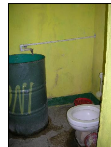
FOTOGRAFIA 07 BAÑO EN SALÓN DE USOS MÚLTIPLES CON FUGAS
