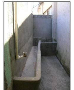
FOTOGRAFIA 06 MUNGITORIO EN SALÓN DE USOS MÚLTIPLES
