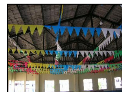
FOTOGRAFIA 08 ESTRUCTURA DE SALÓN DE USOS MÚLTIPLES LAMINA CON FILTRACIONES
