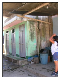
FOTOGRAFIA 01 SERVICIOS SANITARIOS EN MAL ESTADO
