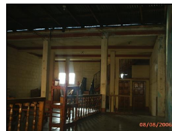
FOTOGRAFIA 02 SALON CON HUMEDAD EN MUROS
