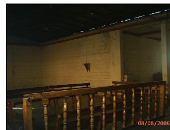
FOTOGRAFIA 03 HUMEDAD POR FILTRACION EN CUBIERTA
