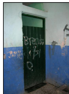
FOTOGRAFIA 08 BAÑO EN MAL ESTADO
