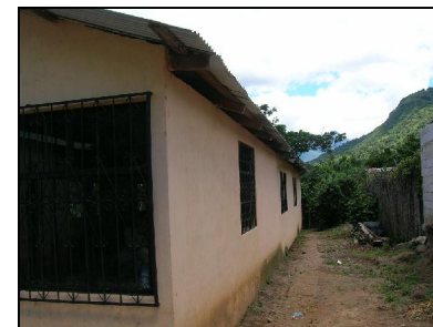
FOTOGRAFIA 01 LATERAL DEL EDIFICIO, EXISTE HUMEDAD EN MUROS
