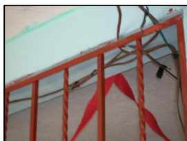
FOTOGRAFIA 06 INSTALACIONES ELÉCTRICAS EXPUESTAS
