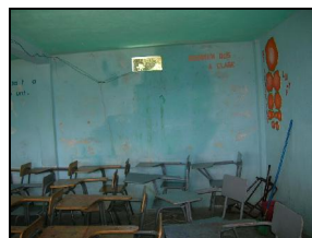
FOTOGRAFIA 09 MURO POSTERIOR CON HUMEDAD
