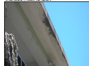
FOTOGRAFIA 01 HUMEDAD EN VOLADIZO NIVEL 2
