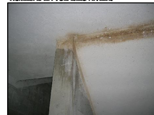
FOTOGRAFIA 02 HUMEDAD EN GRADAS HACIA AZOTEA
