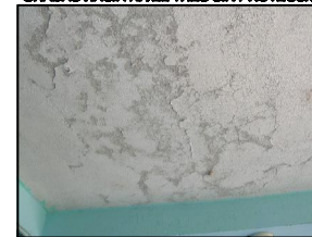
FOTOGRAFIA 05 HUMEDAD EN CUBIERTA FINAL
