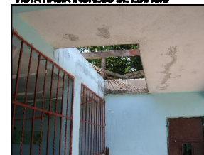
FOTOGRAFIA 03 HUMEDAD EN CUBIERTA FINAL
