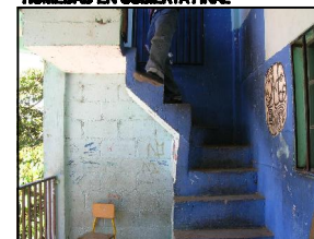
FOTOGRAFIA 04 GRADAS HACIA NIVEL TRES SIN PROTECCIÓN
