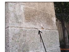
DESPRENDIMIENTO DE MATERIAL
