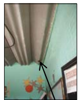
FILTRACION DE AGUA
