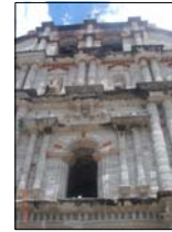
PRESENCIA DE HUMEDAD
