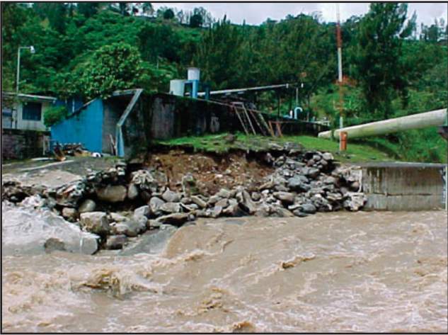
Foto 6.2. Daños en el paso del río Agua Caliente
