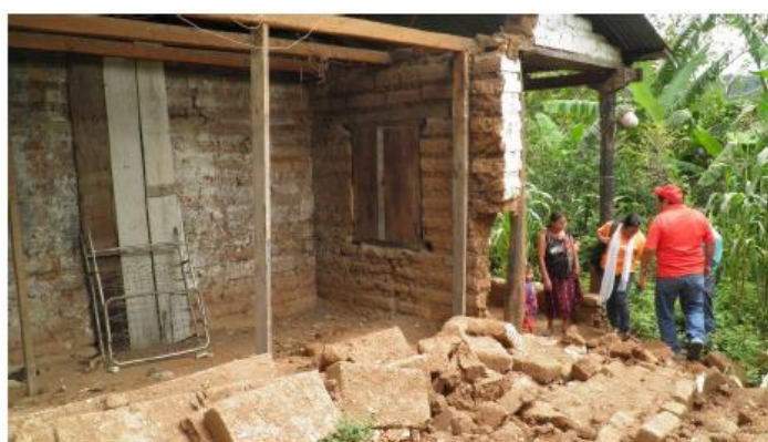
Vivienda con daño severo en San Ildefonso Ixtahuacán (Rosenda Gabriel).
