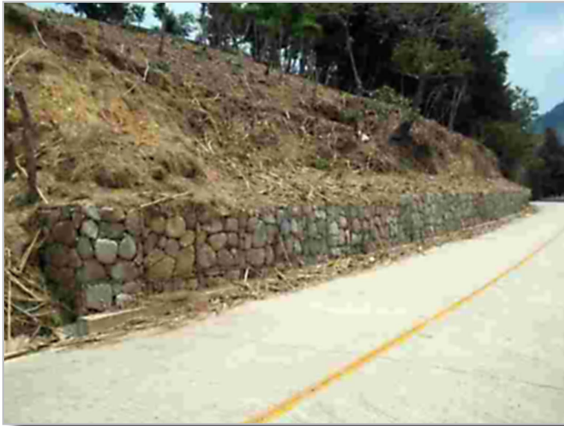
Gaviones de protección carretera Las Pilas, Cantón Río Chiquito, San Ignacio, Chalatenango (Foto: TRIFINIO/GTZ)
