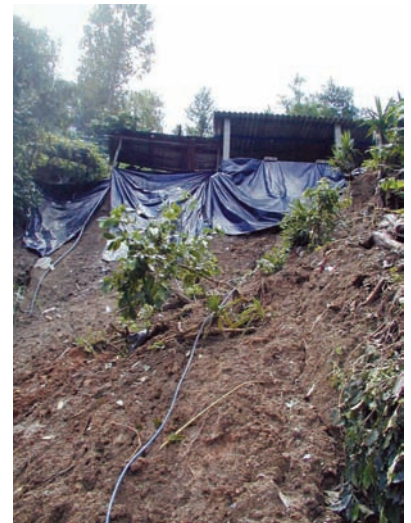
Viviendas afectadas por deslizamiento disparado en octubre de 2005 como efecto de la Tormenta Stan, en Comunidad El Zarzal, La Palma, Chalatenango.
